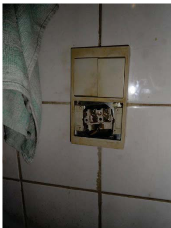
centraalplaat stopcontact ontbreekt; delen onder spanning aanraakbaar
