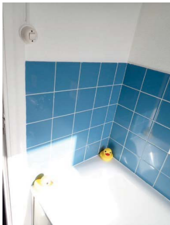
schakelaar naast bad
