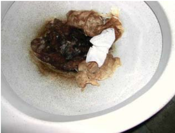
toilet spoelt niet door
