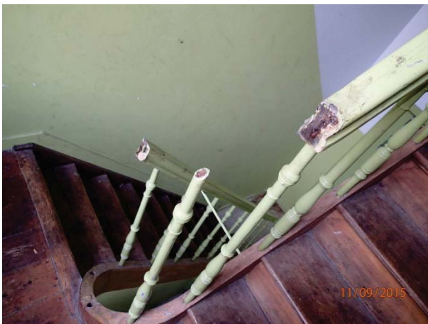
twee ontbrekende spijlen aan het bordes deel van de handgreep ontbreekt
