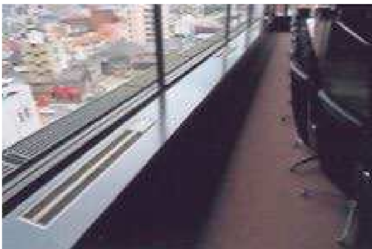
Figuur 205: Ventilconvector ingewerkt onder de ramen
