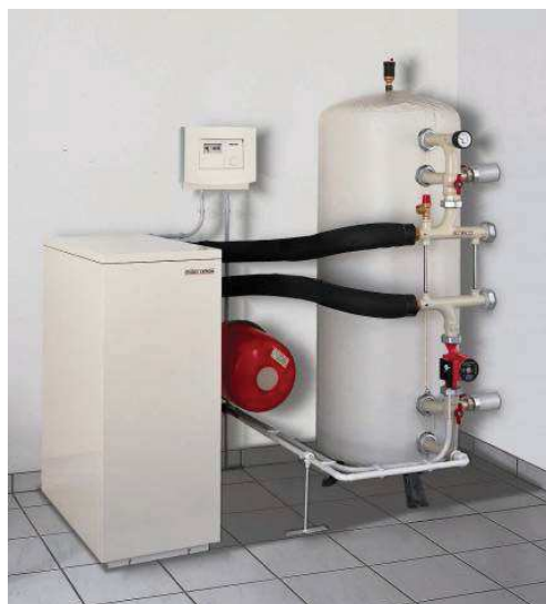
Figuur 144: Warmtepomp en voorraadvat voor sanitair warm water
