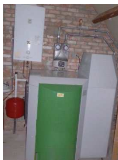
Pelletketel met zuigsysteem en opslag
