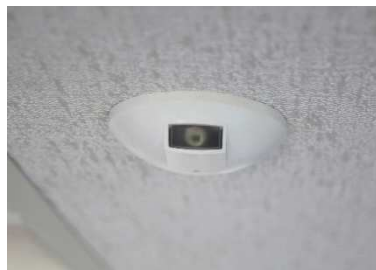
Figuur 91: Daglichtsensor aan het plafond
