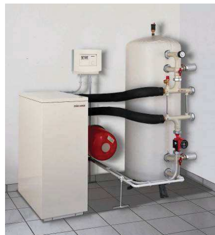
Figuur 218: Warmtepomp met voorraadvat
