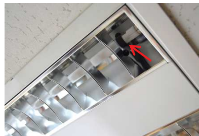
Figuur 92: Daglichtsensor op TL-verlichting in een armatuur
