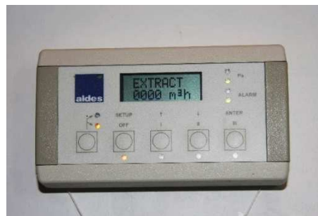
Figuur 70: Manuele schakelaars
