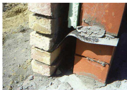
Figuur 99: Voorbeeld van uitvoering waarbij er geen isolatie aanwezig is aan de onderzijde van de muur.
