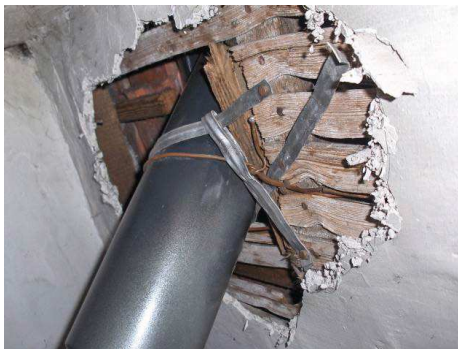
Figuur 80: Onafgewerkte doorvoeropeningen
