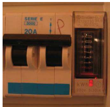
Figuur 143: Extra elektriciteitsteller
