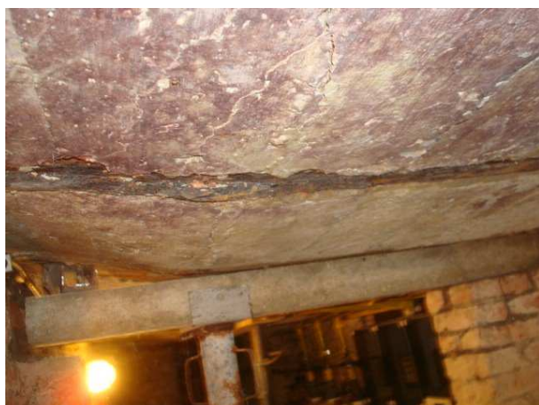
ernstig verzakte vloer boven kelder
