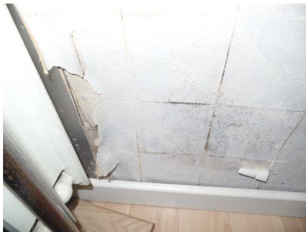
opstijgend vocht in binnenmuur
