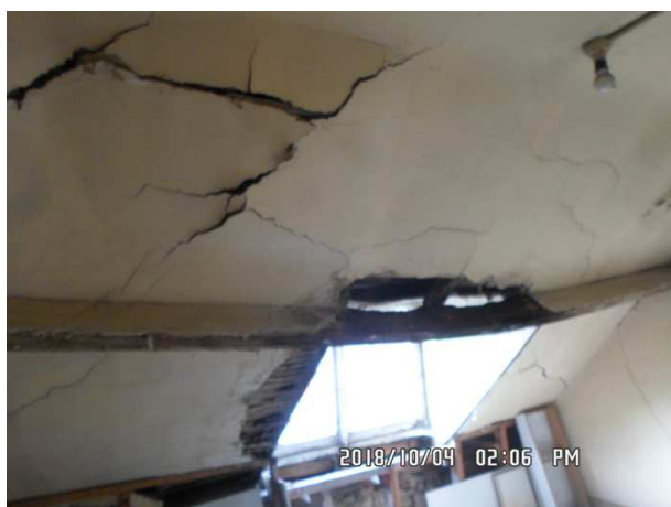
gording, keperwerk, dakkapel ernstig aangetast
