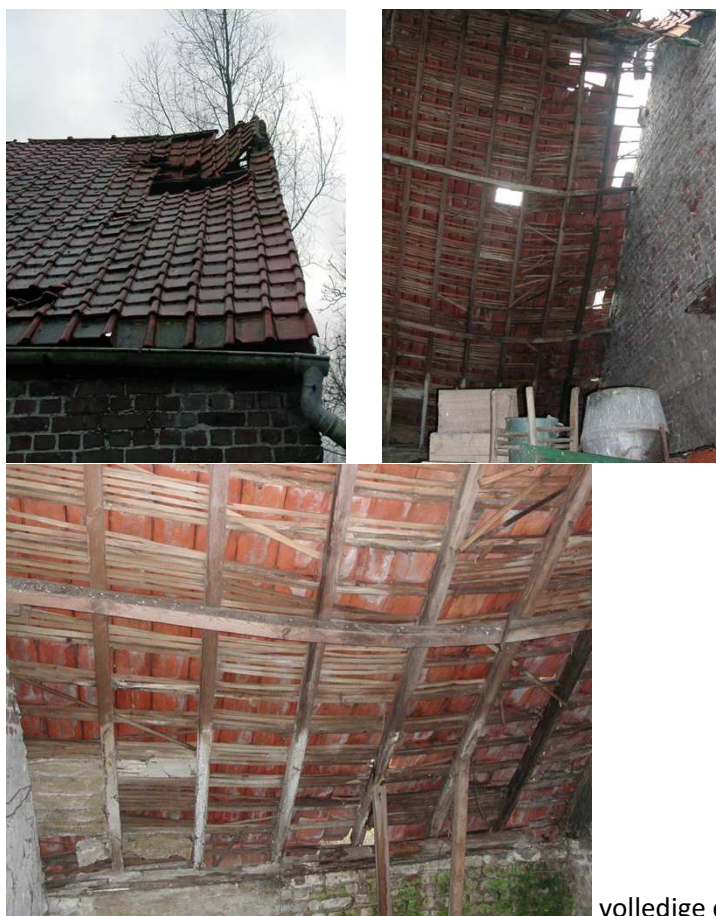
volledige dakstructuur aangetast
