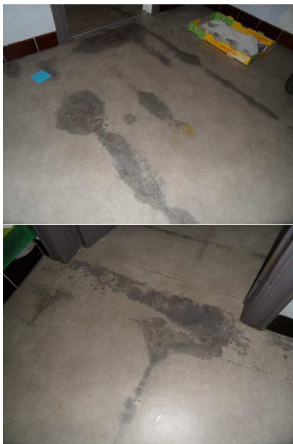
vochtschade aan linoleumvloer
