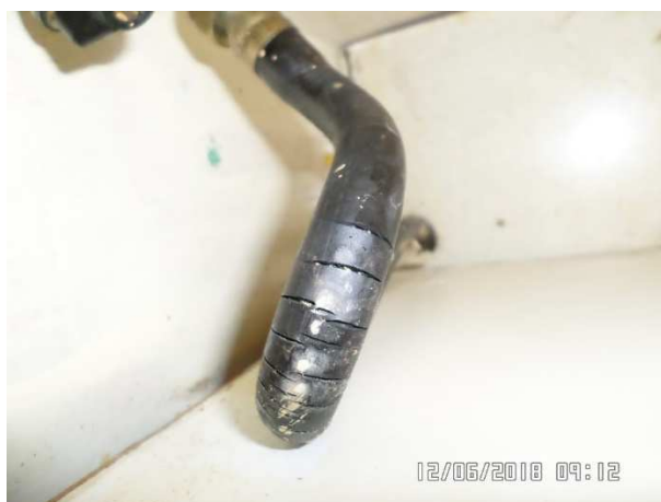
beschadigde elastomeren slang
