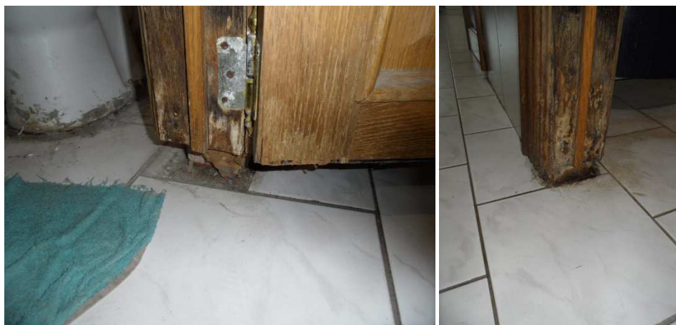
opstijgend vocht in houten deurkader
