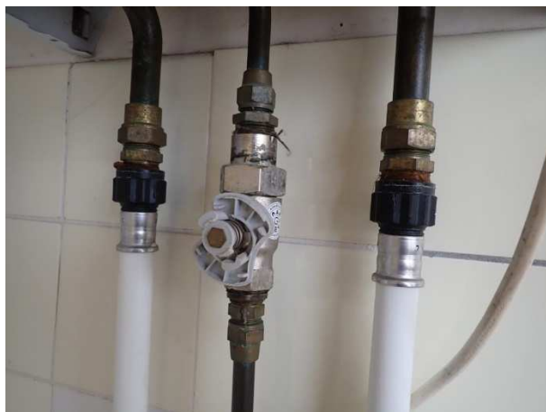
gaskraan beschadigd – niet afsluitbaar
