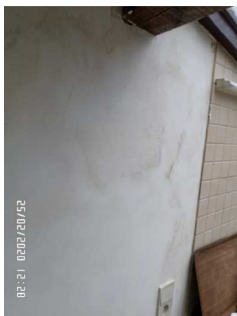
opgedroogde schade na vochtinsijpeling
