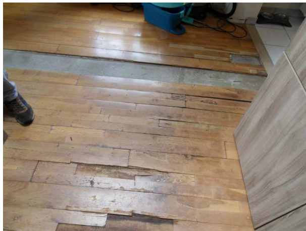
gevolg van vochtschade aan parketvloer
