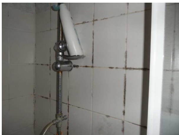
schimmelvorming op voegen badkamertegels
