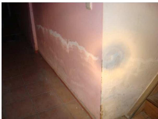
schade door opstijgend vocht
