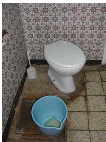
toilet niet aangesloten op watertoevoer
