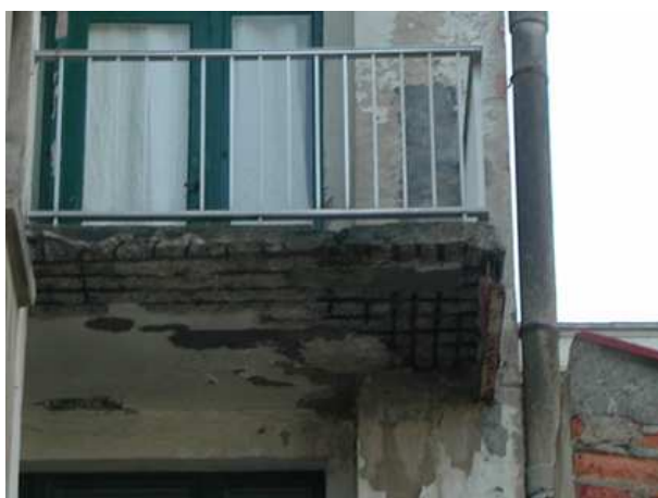
terrassen met ernstig betonrot
