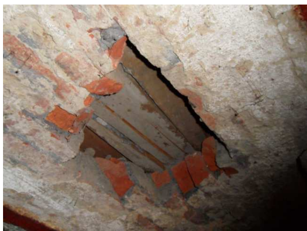
deel van welfselvloer boven kelder ontbreekt
