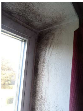
condensatie met schimmelvorming
