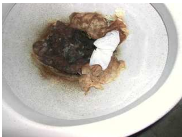
toilet spoelt niet door
