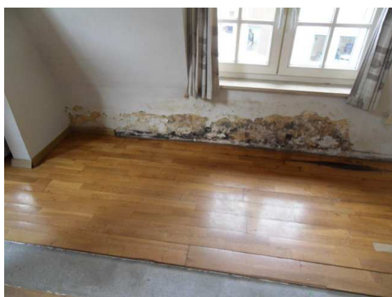
doorslaand vocht op verdieping
