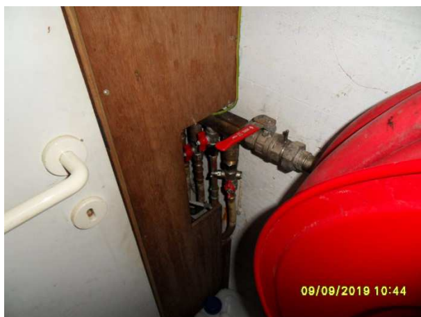
watermeter niet bereikbaar
