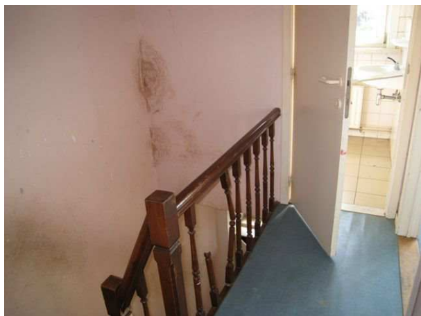
vocht met schimmelvorming op binnenmuur
