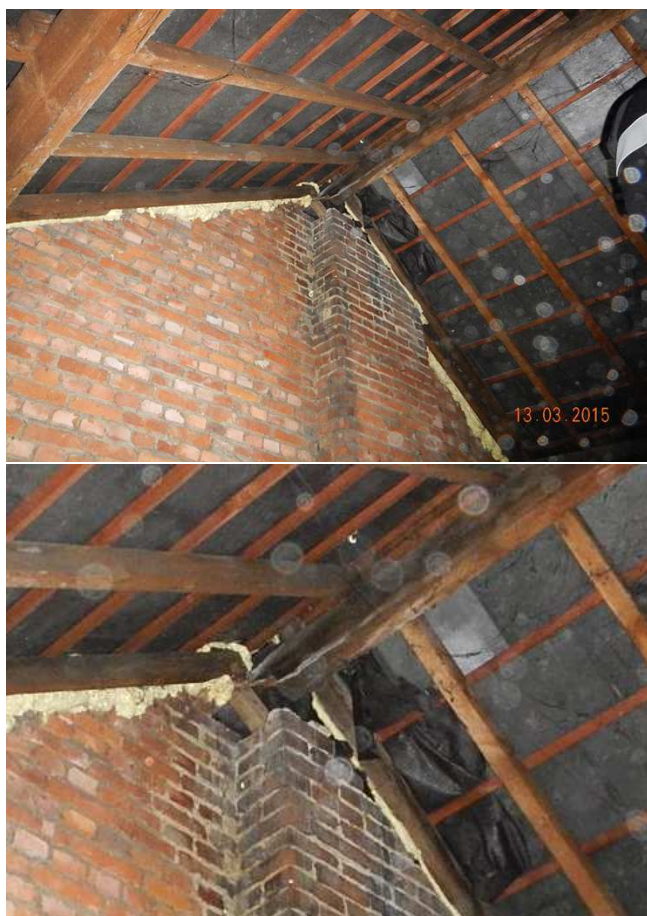
nokbalk beschadigd en draagt niet meer
