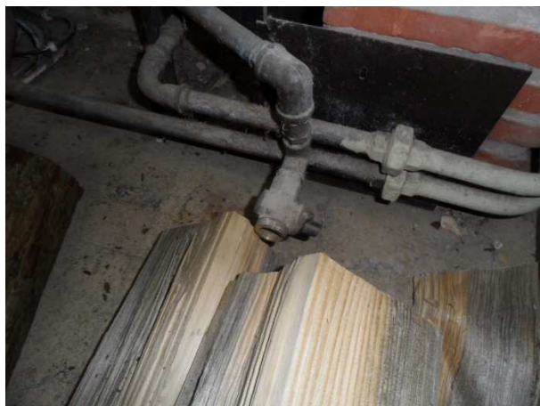
gasdop ontbreekt op wachtleiding
