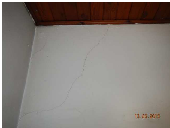
barsten in bovenhoek binnenmuur
