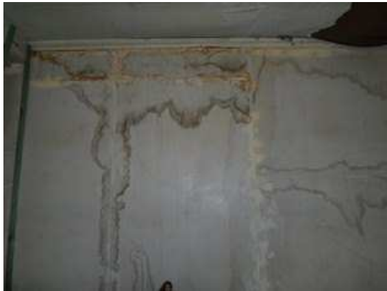
vochtschade op gemeenschappelijke muur
