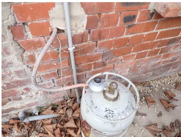
verweerde slang, foutief aangesloten
