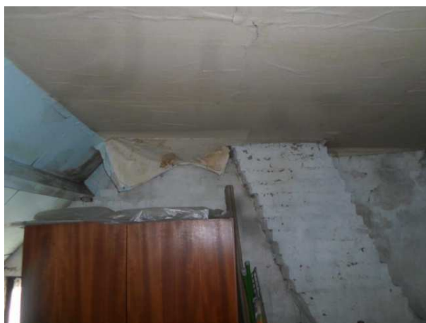
ernstige vochtinsijpeling via dak en plafond
