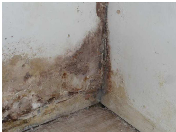
opstijgend vocht met schimmelvorming
