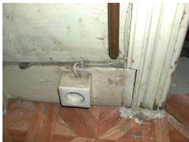
stopcontact ontbreekt in de slaapkamer
