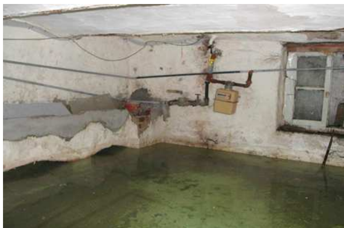
Watermeter (en gasmeter) niet afsluitbaar
