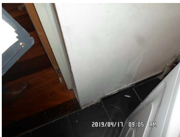
opstijgend vocht op binnenmuur
