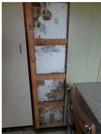
opstijgend vocht met schimmelvorming achter voorzetwand
