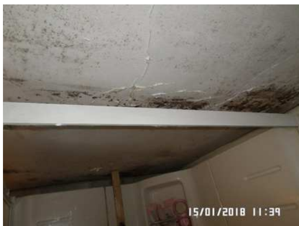
condens en schimmelvorming plafond badkamer
