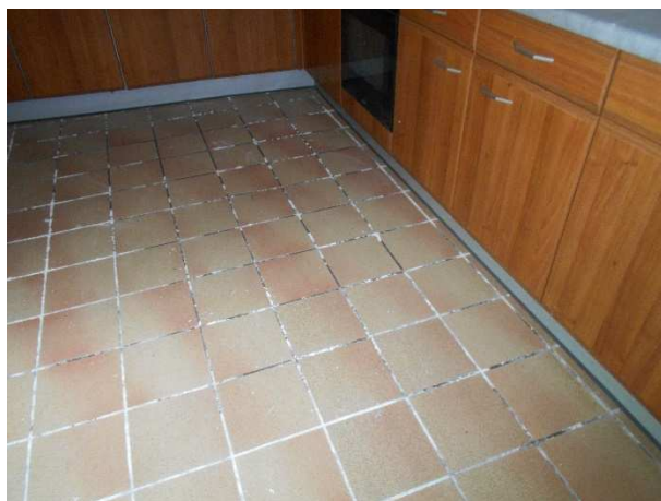
verkleurde voegen in tegelvloer
