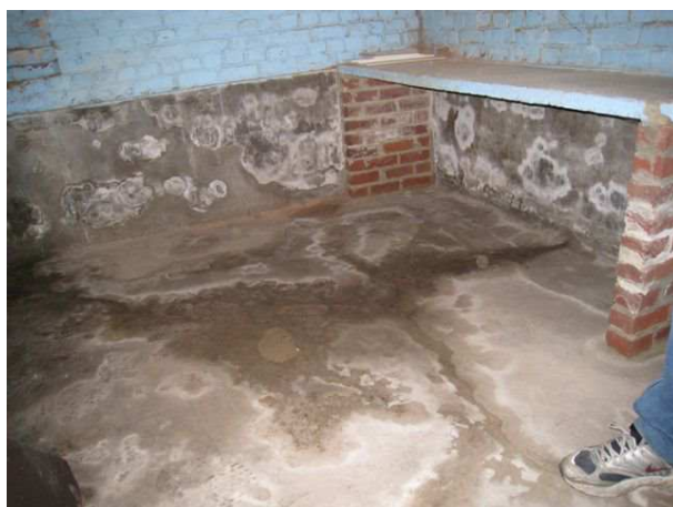
lichte vochtschade op kelderwanden en -vloer
