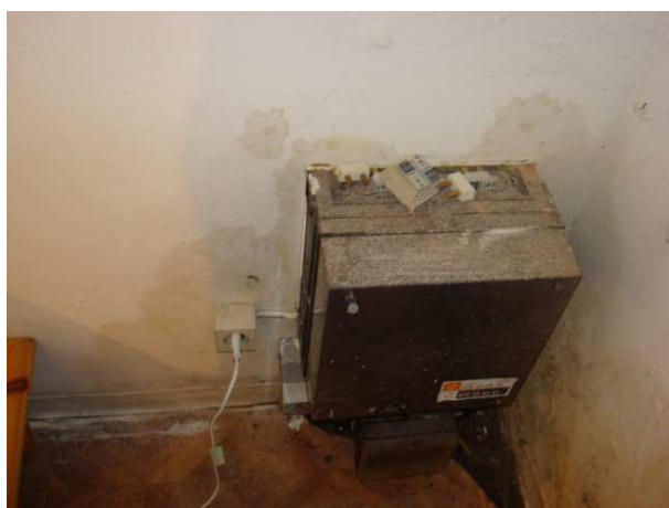
opstijgend vocht in binnenmuur
