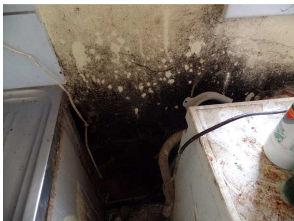
opstijgend vocht met erge schimmelvorming
