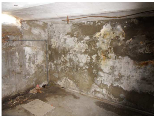
vochtige muren en plasvorming
