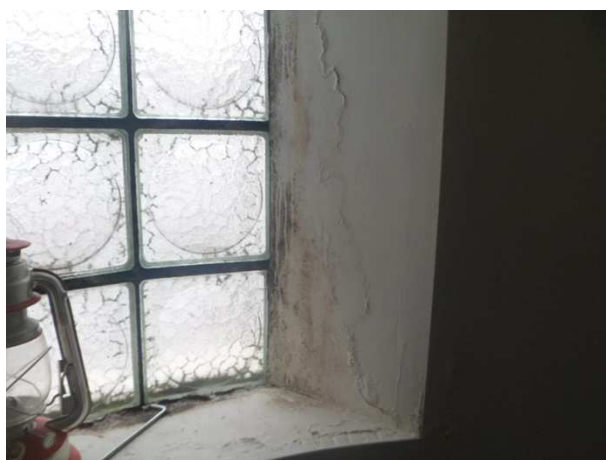
condens en schimmelvorming in een raamneg
