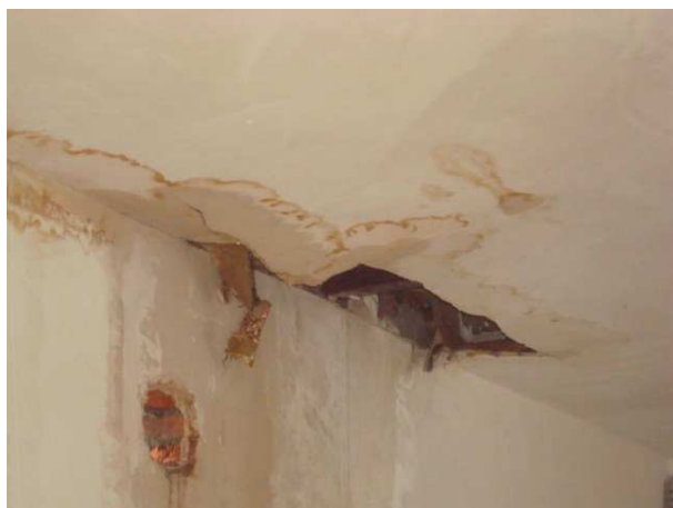
vochtschade door insijpelend vocht
