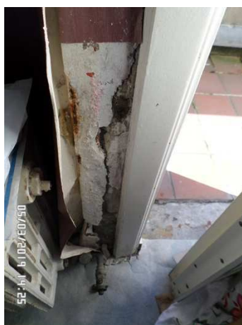
opstijgend vocht in buitenmuren
