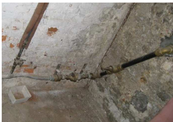
opstelling watermeters in een meergezinswoning
