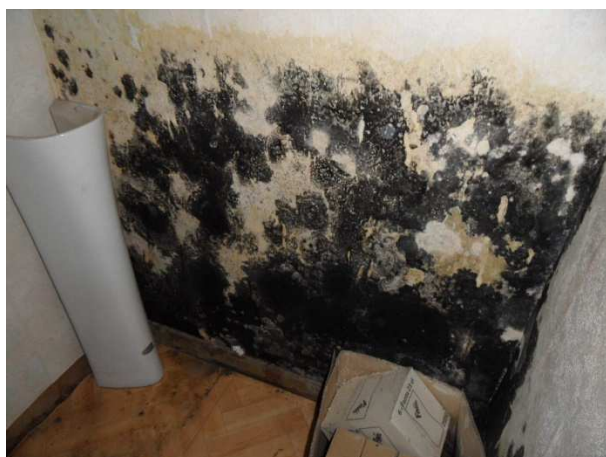
opstijgend vocht met schimmelvorming
