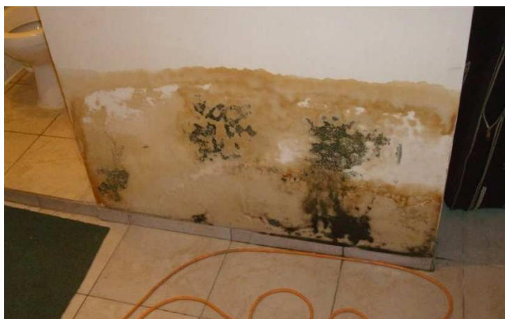
opstijgend vocht met schimmelvorming
