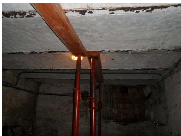
onvakkundig stutwerk van een kelderplafond
