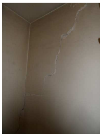
scheurvorming dragende binnenmuren
