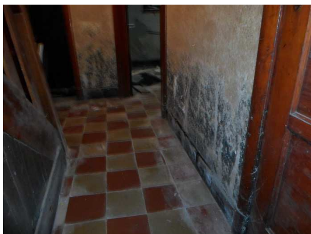
ernstige vochtschade met schimmelvorming in de gemeenschappelijke traphal
