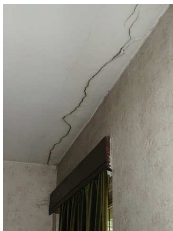
barst in dragende binnenmuur en plafond
