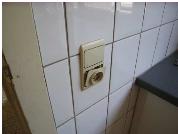
middelste afdekplaat stopcontact zit los
