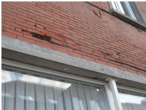
loszittende stenen en voegwerk
