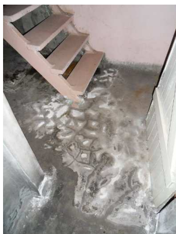
zoutvorming op keldervloer
