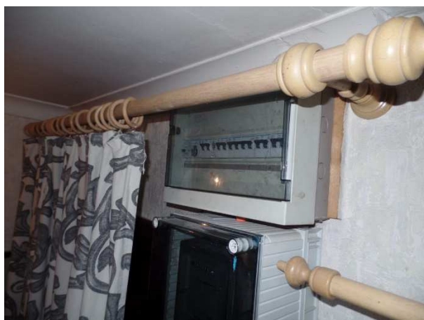
Zekeringkast moeilijk bereikbaar
