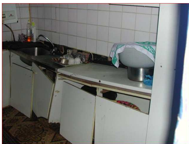
gootsteen verzakt – niet aanwezig
