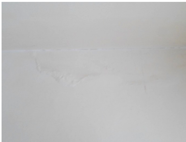
opgedroogde vochtschade bovenaan buitenmuur
