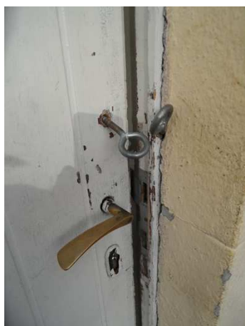
woning niet slotvast afsluitbaar
