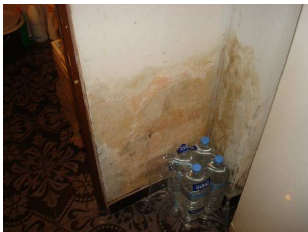
opstijgend vocht in binnenmuur
