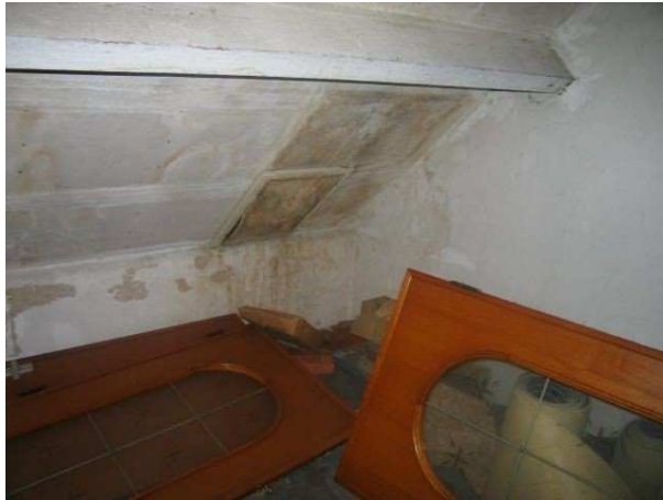
ernstige vochtschade aan het dak
