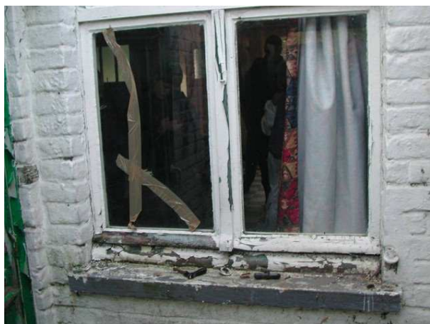
Dubbele beglazing ontbreekt in een woonlokaal
