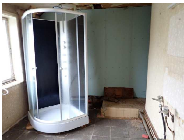
douche niet aangesloten (niet aanwezig)
