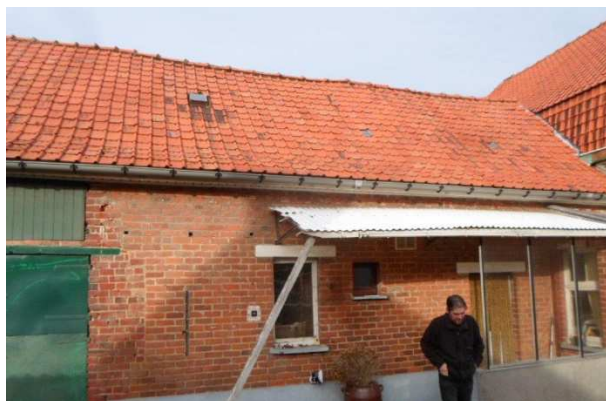
Onvakkundig ondersteund afdak.
