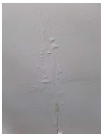
kleine zone met opgedroogde vochtschade aan plafond
