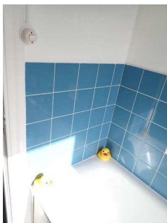
schakelaar naast bad
