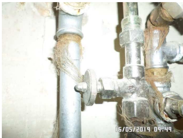
foutieve gaskraan aanwezig
