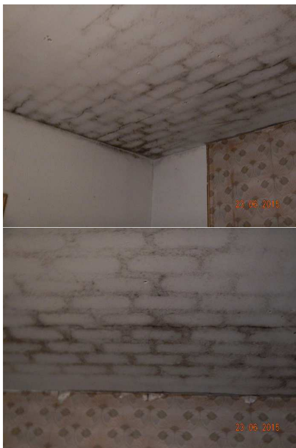
condensatie met schimmelvorming aan plafond
