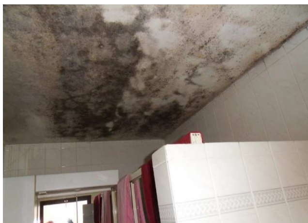
condensatie met schimmelvorming plafond
