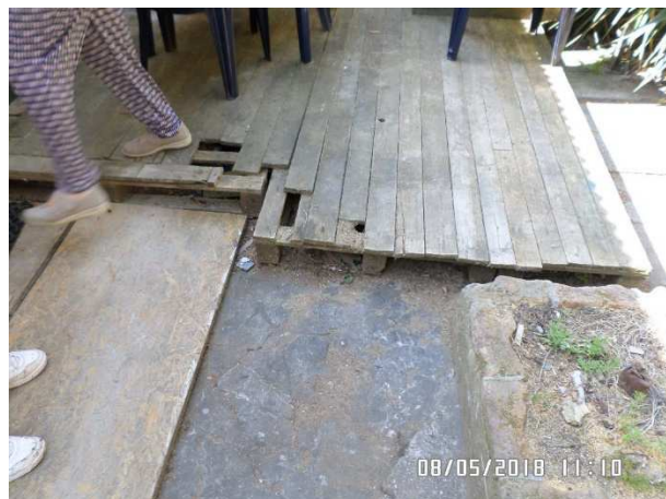
Onafgewerkte terrasvloer met oneffenheden.
