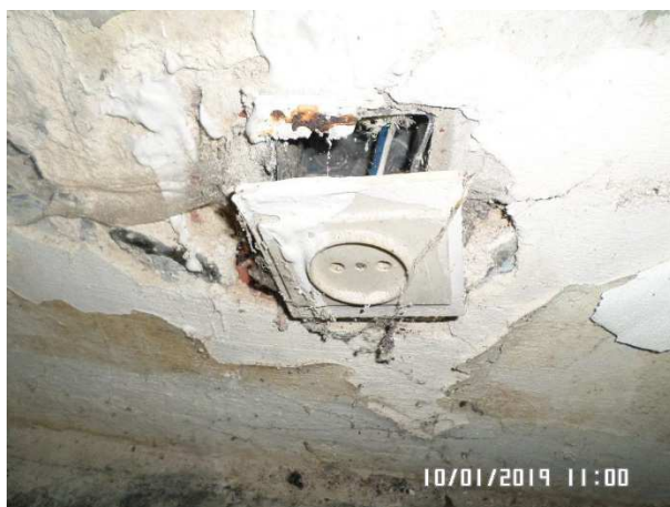
opstijgend vocht in binnenmuur
