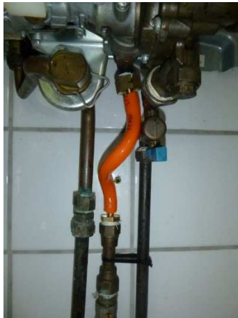
foutieve aansluitleiding en aansluitwijze gebruikt
