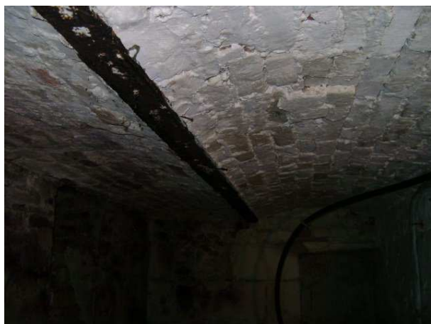
sterke roestvorming op draagprofiel kelderwelfsel
