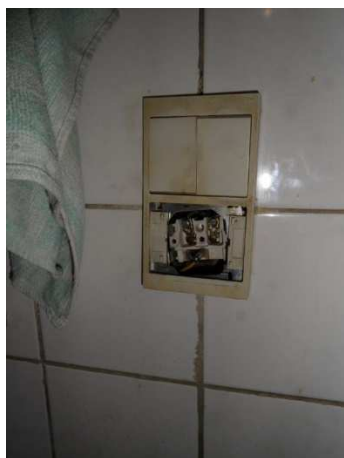
centraalplaat stopcontact ontbreekt; delen onder spanning aanraakbaar
