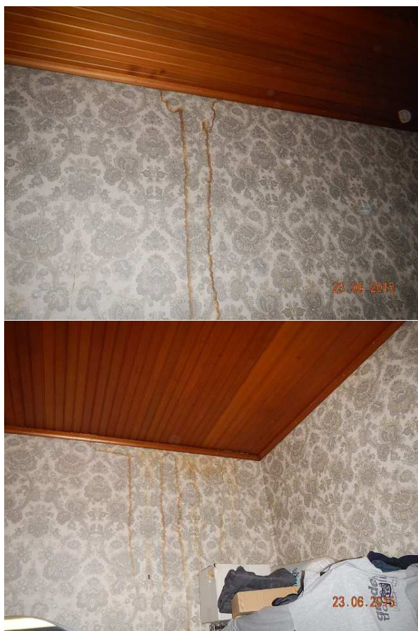
insijpeling van vocht via het dak
