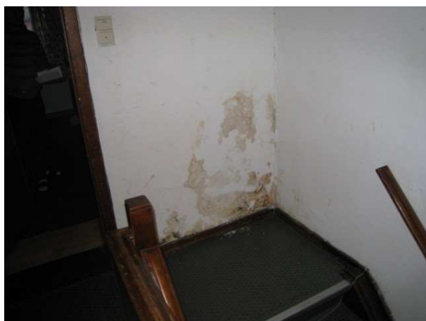
opstijgend vocht in binnenmuur
