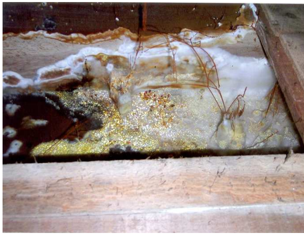
huiszwam aan kelderplafond
