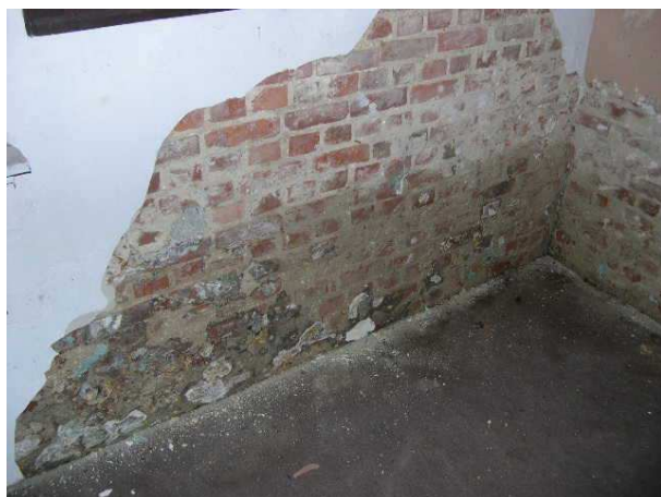
schade door opstijgend vocht
