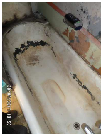
bad ernstig beschadigd
