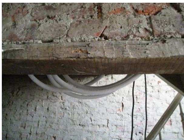
houten draagbalk aangetast door houtworm
