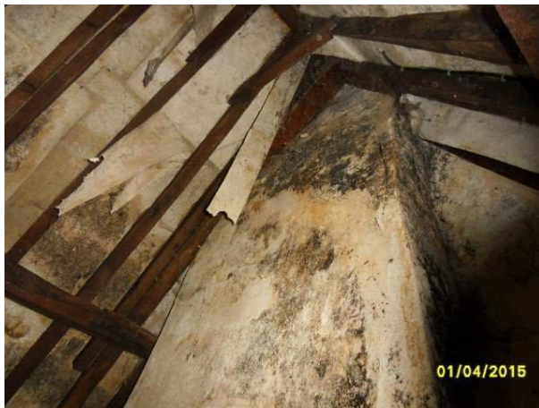
ernstige vochtschade aan het dak
