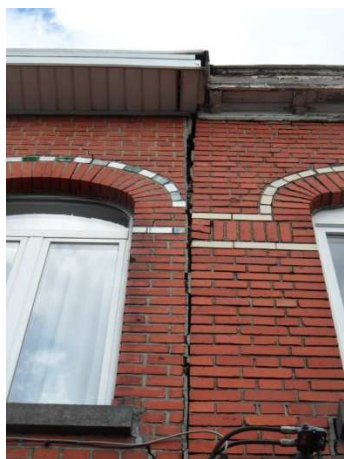
barst tussen twee gebouwen
