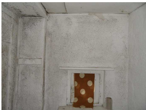
condensatie met schimmelvorming
