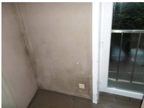
condensatie met schimmelvorming
