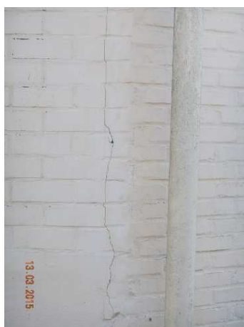
barst in zijgevel
