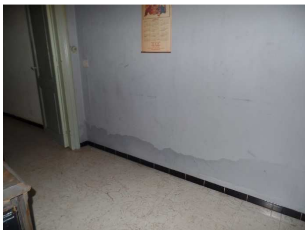
opstijgend vocht over een volledige muur
