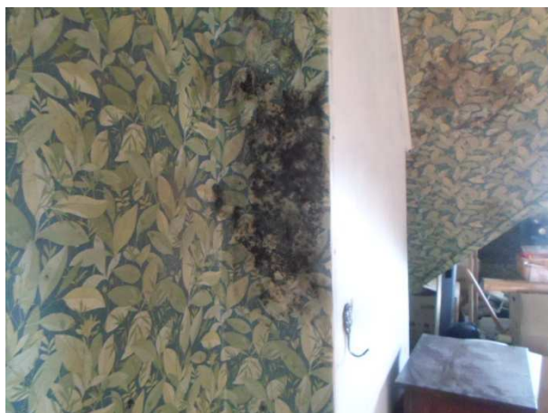
condensatie op een wandje onder dak
