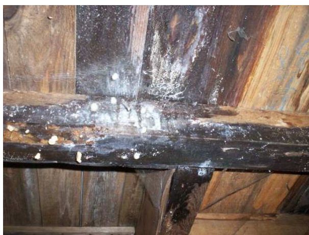
houten draagvloer aangetast door schimmel
