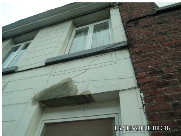
diagonale barst boven voordeur in straatgevel
