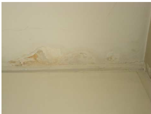
vochtschade door insijpelend vocht plafond gemeenschappelijke gang
